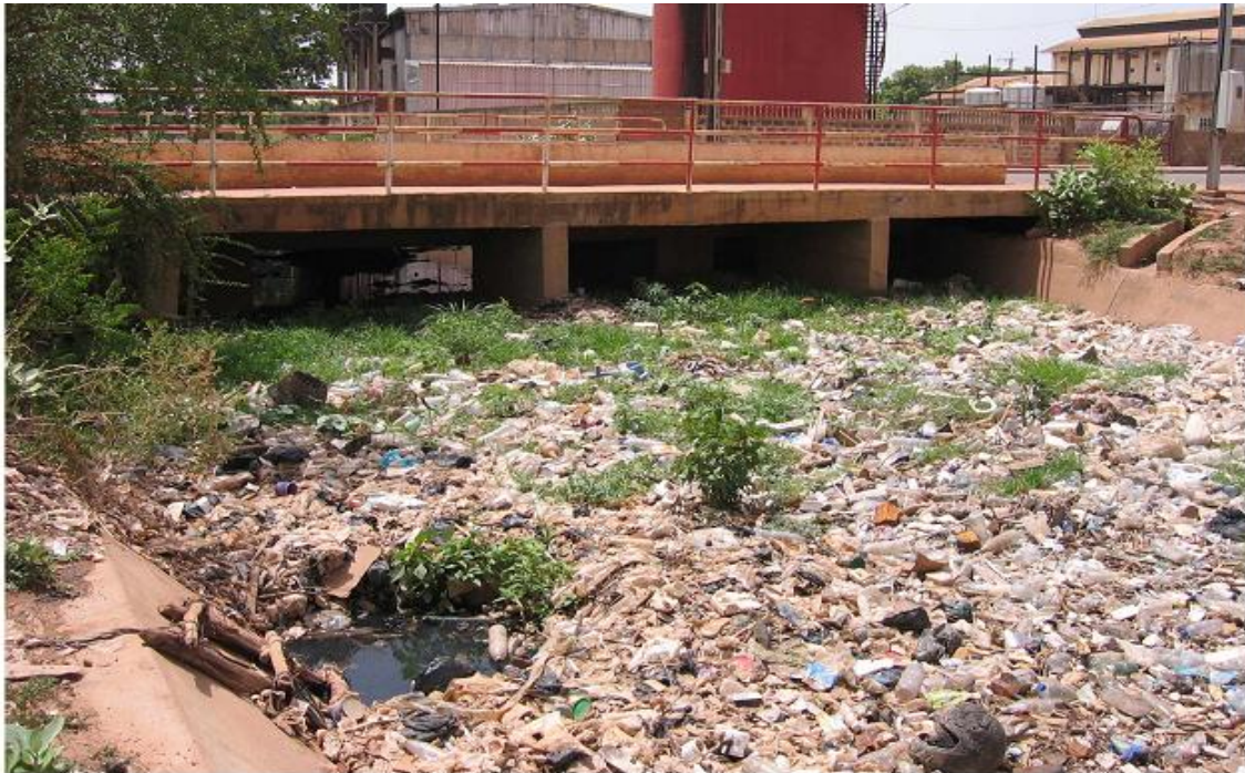
Figure 7.4 Un réseau d'évacuation de Ouagadougou (Burkina Faso) (Tiré de CIFAL, 2011)
